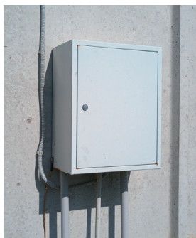
配電盤・電灯付近
