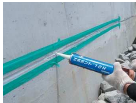
▲ひび割れへエポボンド1CHを使用
