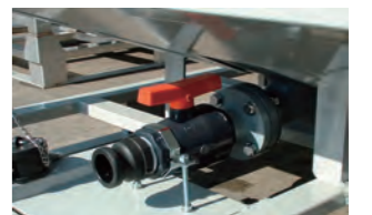
配管部はフランジになっており、強度的にも強く、メンテナンスも比較的容易です。
