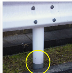
ガードレール支柱地際部
