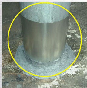
鋼製街灯地際部
