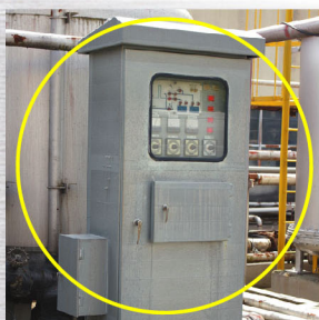
屋外制御盤外面
